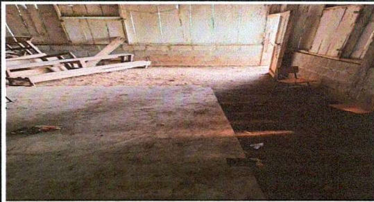
Foto 1: Se observa el deterioro del piso.
