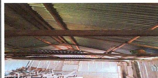
Foto 5: Deterioro de techo de todas las láminas.
