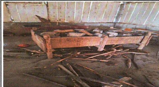
Foto 2: Se observa deterioro de la cocina.
